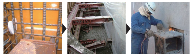
鉄筋組立・型枠設置工 コンクリート打設工・支保工撤去工 切断工
