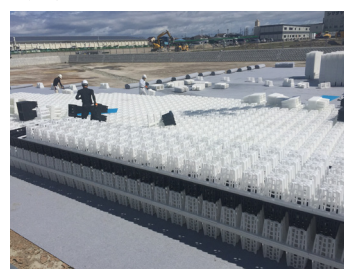
設置例（東北地方某工場）
