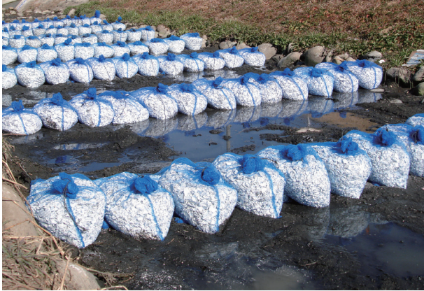
セルカ 設置例（水路での生活排水の水質改善）
