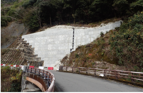
道路の山側拡幅の例 (熊本県五木村内) 勾配1:0.0 (垂直) 最大高16.9m
