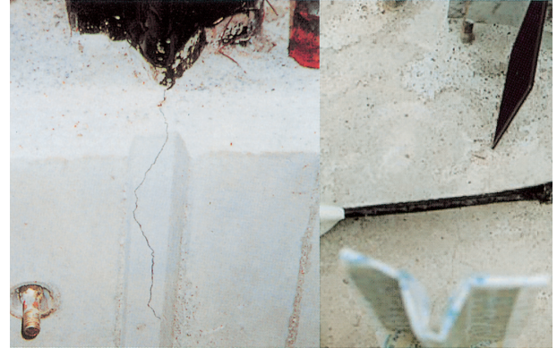
「Spanshield誘発目地材」クラック発生状況
