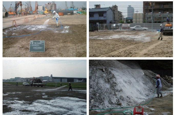
①平地(建設工事現場) ②平地(解体跡地) ③平地(空港関連工事) ④盛土(仮置土)
