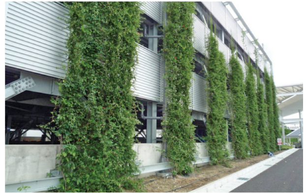
のぼるtoみどりワイヤー施工例 (1年9カ月 のぼるtoみどりソイル使用)
