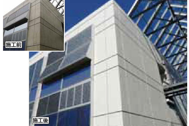
ピアレックスRC工法施工実績 (鹿島建設技術研究所、施工2007年)
