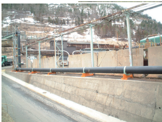
プラント配管
