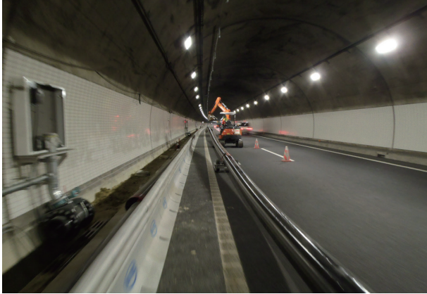
施工例 (トンネル消火設備配管)
