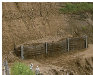
連続流下による土砂満載状況
