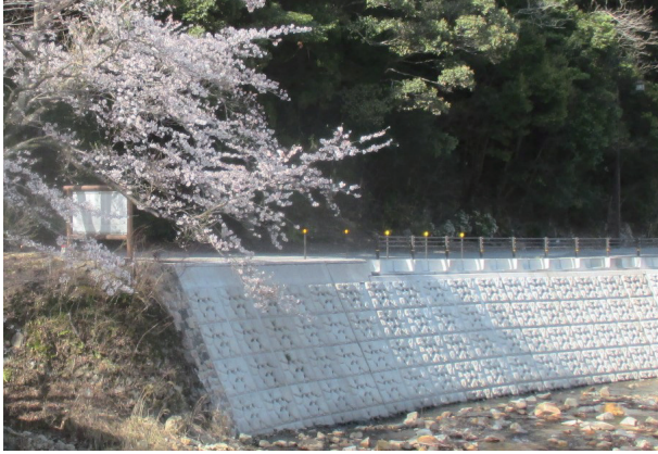
エコボックス 施工例
