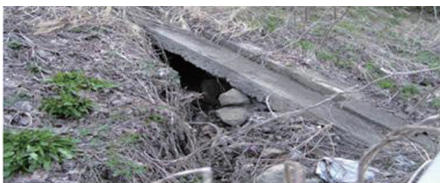
通水障害により水が溢れ、法面が洗掘された例
