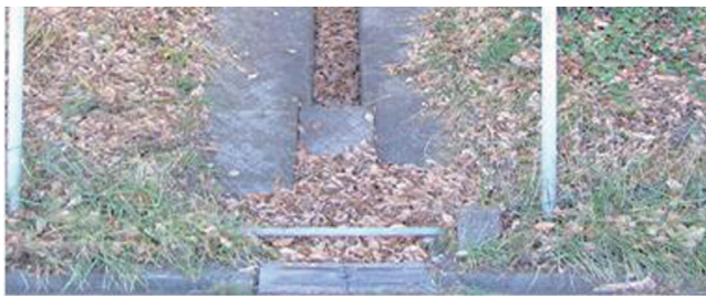
たて排水溝の通水障害の例
