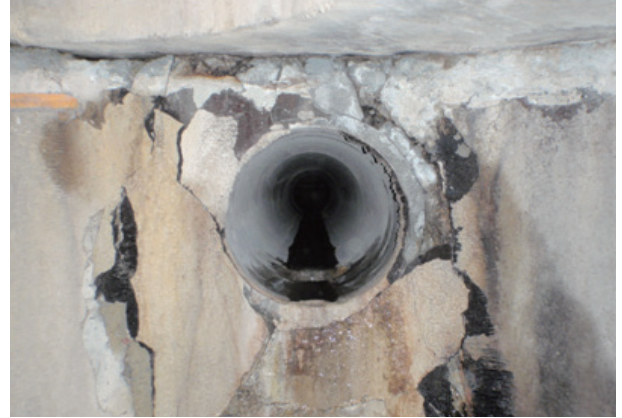
地震による下水管とマンホール接続部の損傷
