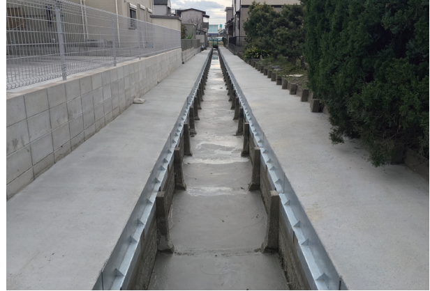
施工例（愛知県あま市）
