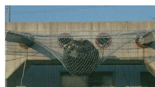
無補強の衝突スパン両側の支柱 (ねじれが発生)
