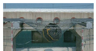
補強した衝突スパン両側の支柱 (ねじれは発生していない)
