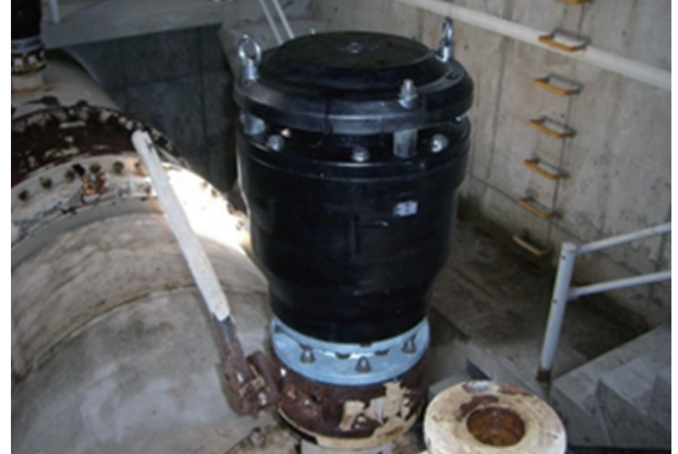
設置状況 (一ツ瀬川)
