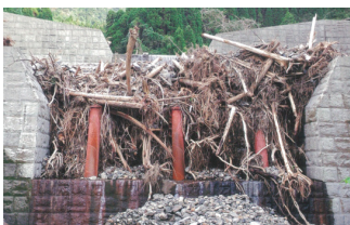
流木捕捉事例：鹿児島県 (鋼製スリットダムA型)
