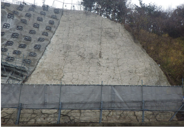
ELAST GUARD工法による老朽モルタル修復前
