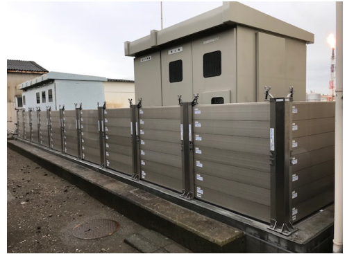
電気設備設置例
