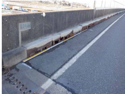
2. 従来製品の錆腐食状況
