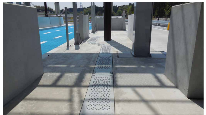
アイランド内 軽量ダクト
