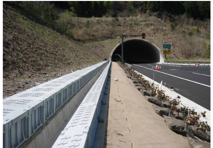
高速道路内 軽量ダクト
