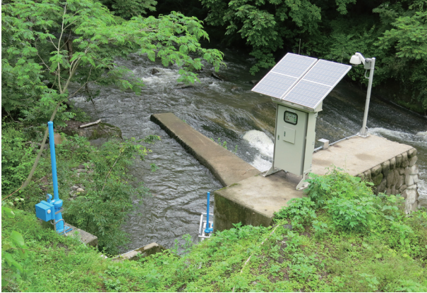
設置例：長野市豊野川谷地区 日影堰水門
