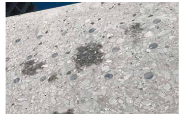
コンクリート床版/スタッド切断後の状況
