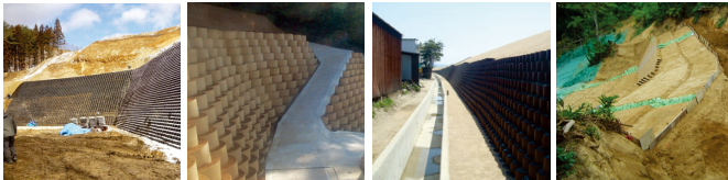
メガソーラ工事（福岡） 擁壁工（愛知） 堤防強化工事（鳥取） 治山工事（沖縄）
