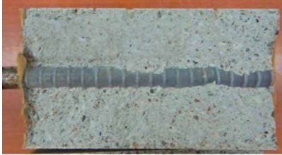
アクアシール1400AR 鉄筋に腐食なし
