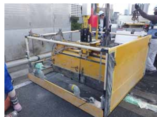
設置式オートチッパーによる施工状況 ※NETIS登録番号：KT-210057-A
