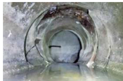
破損状況確認
