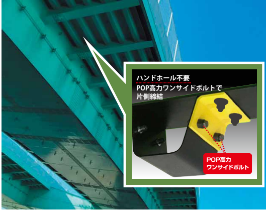
鋼床版U-リブ当て板補修例
