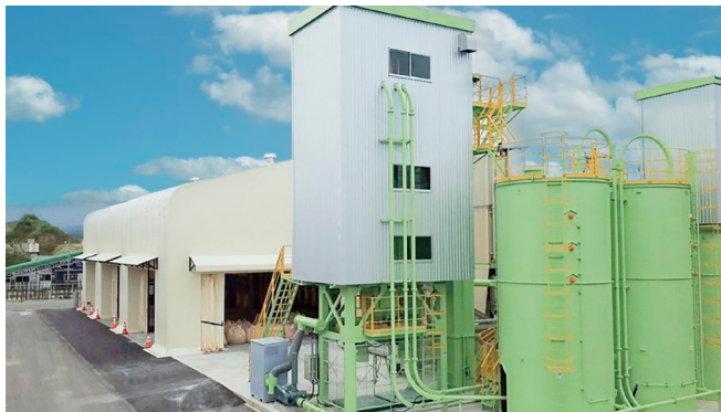
石膏系固化材製造プラント
