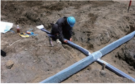
学校グラウンド等の敷地排水
