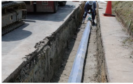
道路路盤・法尻湧水の排水管
