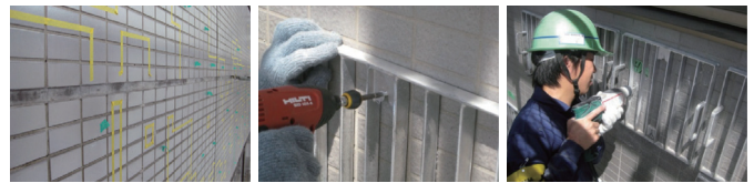
①補修範囲の確認・マーキング ②押さえ金具固定孔穿孔 ③押さえ金具取り付け
