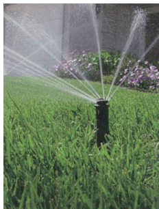
自動散水システム
