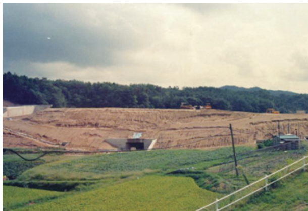
災害により崩壊した法面
