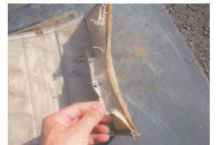
PPクロス部…ボロボロ裂ける ウレタン部厚さ…3mm程度になる
