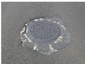
① 損傷マンホール鉄蓋
