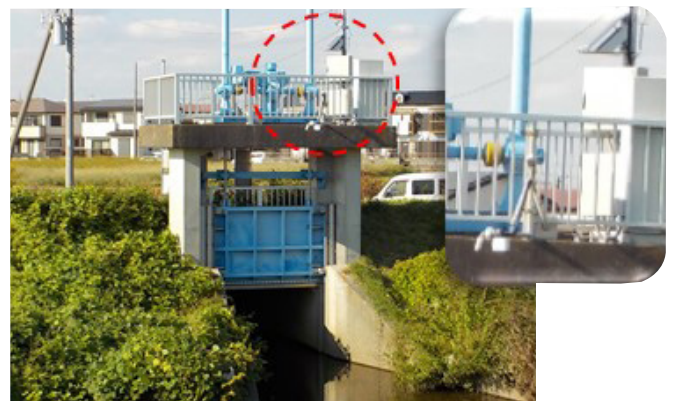
樋門へのWEBカメラ・超音波水位計装置設置事例
