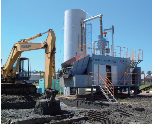
改質プラント「固化ユニットFBE」
