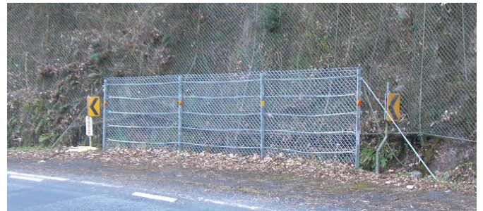
落石防護網の補助として設置
