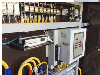
自動制御装置および通信機器
