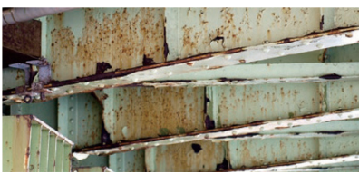
橋梁の塗装剥離 (塩害が厳しい環境)
