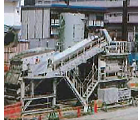
ソイルセメント製造プラント
