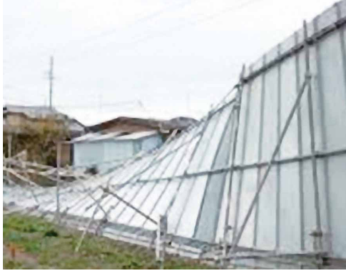
強風で仮囲いが倒壊
