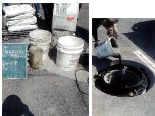
SSコンクリートを 練り混ぜ水量計測 カップに所定量の 水を投入
