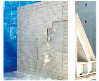
下地タイル剥落
